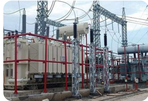
Các công trình về điện trung thế, hạ thế
